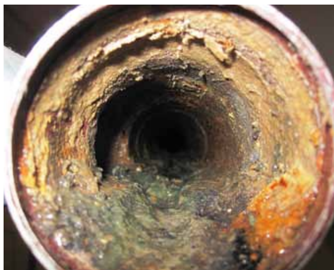
Ablagerungen aus Schwarzwasser in einem Unterdruckentwässerungsrohr nach langer Betriebszeit
