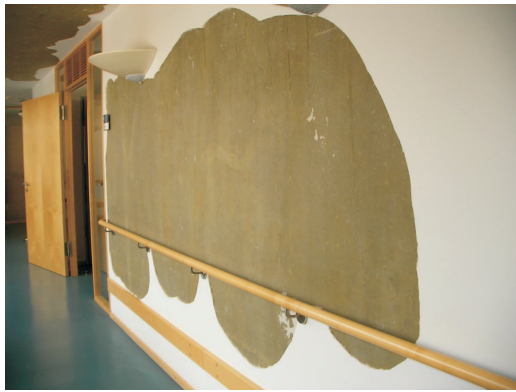
Abb.1 Großflächige Gipsputzablösungen von einer Betonwand.
