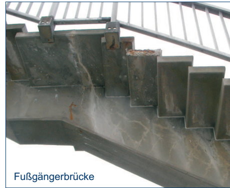
Abb. 1: typischer AKR Schaden
